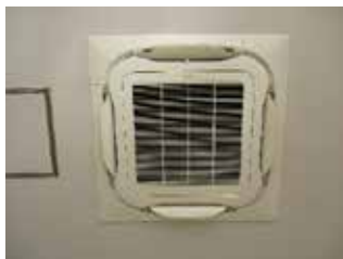
3.2.1.地下1階 空調機(節電タイプ)
