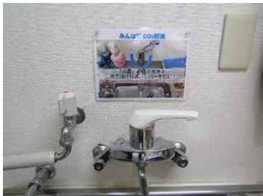
エコ啓発ステッカー 掲示場所：混合栓のある場所 計5か所
