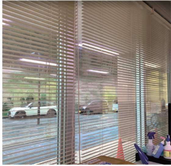
ブラインド並びに断熱フィルムによる遮熱 (1F 事務所)
