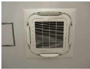
3、2、1、地下1階 空調機(節電タイプ)
