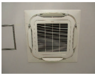
3、2、1、地下1階 空調機（節電タイプ）
