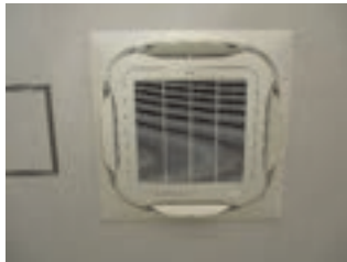
3、2、1、地下1階 空調機(節電タイプ)
